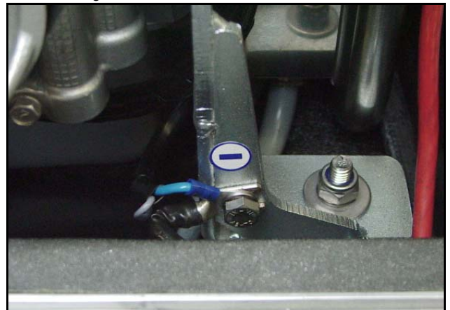
Fig. 5.10.3-4: Minuskabel der Starterbatterie
