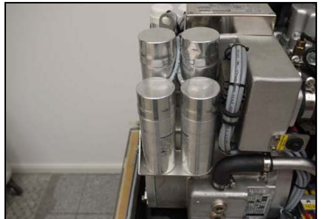
Fig. 5.12.4-2: Kondensatoren für die Erregung
