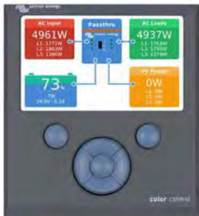
Panel Color Control con una aplicación FV
