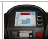
Quadro TG 62-72 Strumentazione con RTE e modulo RTE (esterno)
