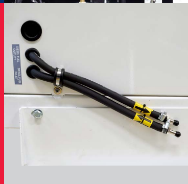
Ingresso e uscita gasolio
