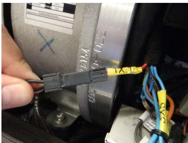
Fig. 3.5-1: Puente de parada de emergencia en el mazo de cables
