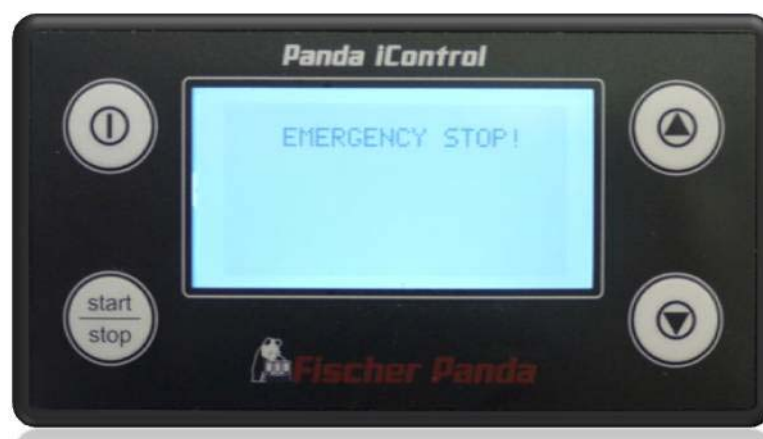
Fig. 3.5-2: Indicación del panel Parada de emergencia
