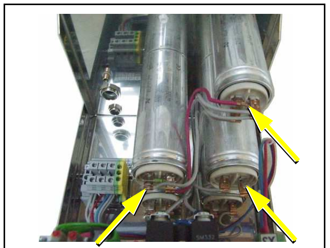
Fig. D.4.1-1: Capacitors
